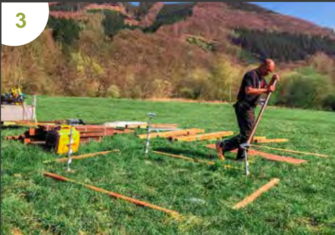
3 In den Ecken werden die Erdankerschrauben mit einer Eisenstange in den Boden gedreht. Siehe auch Seite 40.
